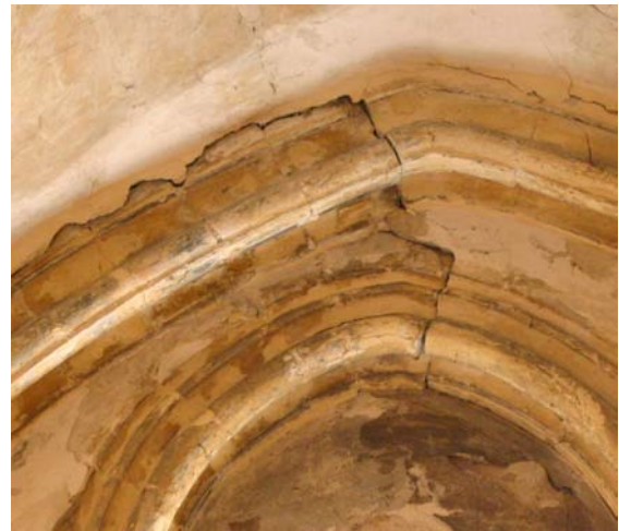
Fissurations et jeu dans les pierres de la voûte
